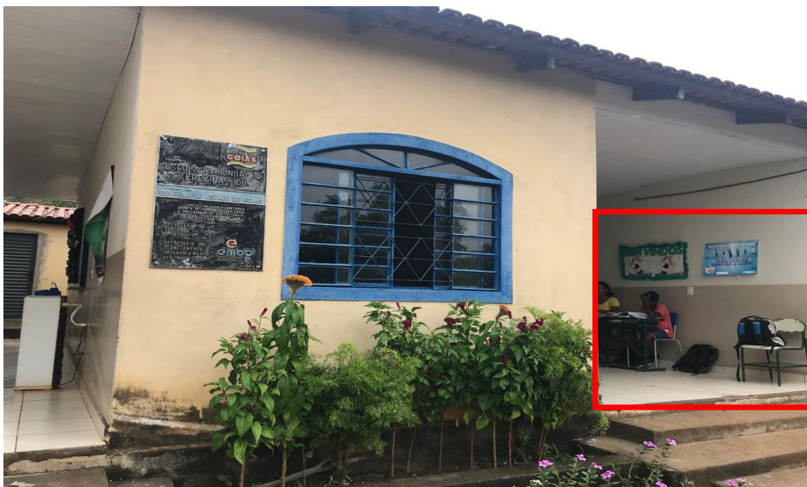
Figura 17: Deficiência no espaço físico: sala de aula improvisada no corredor
